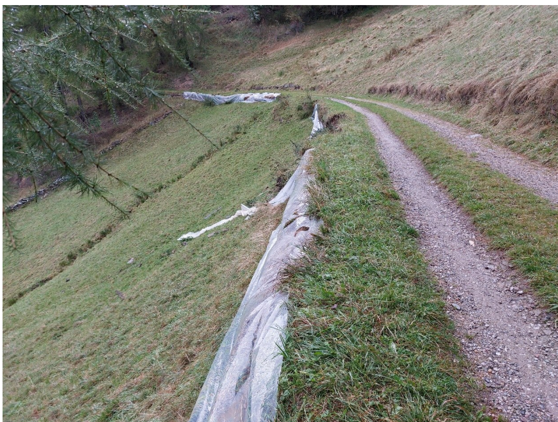
Vista da valle della sede stradale in fase di cedimento
