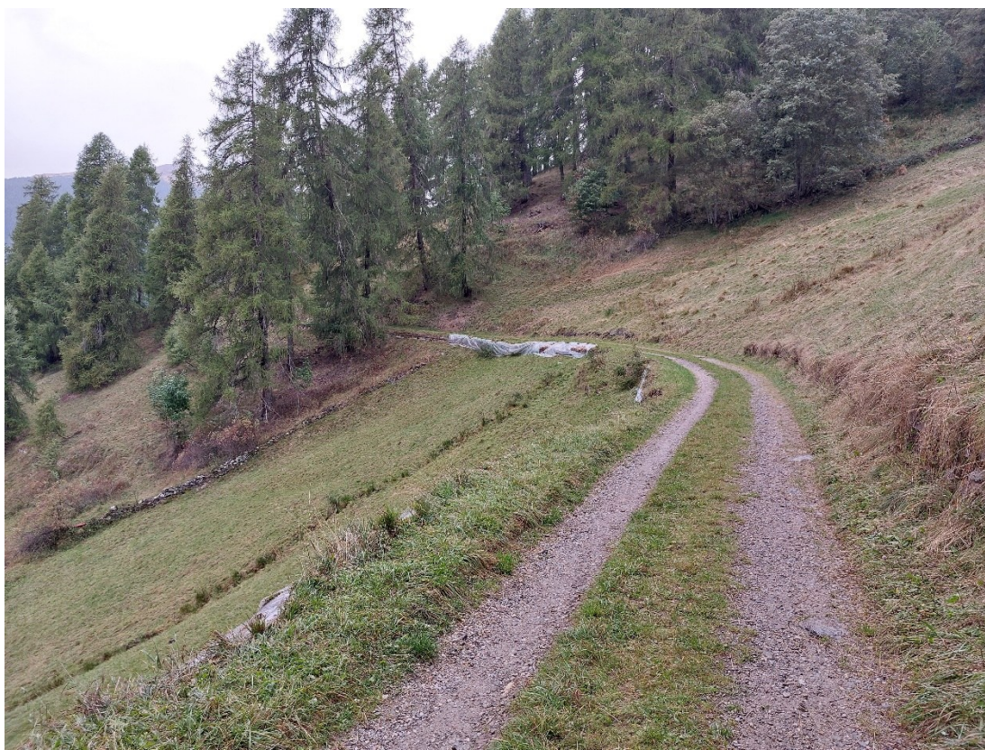
Vista da valle della sede stradale in fase di cedimento
